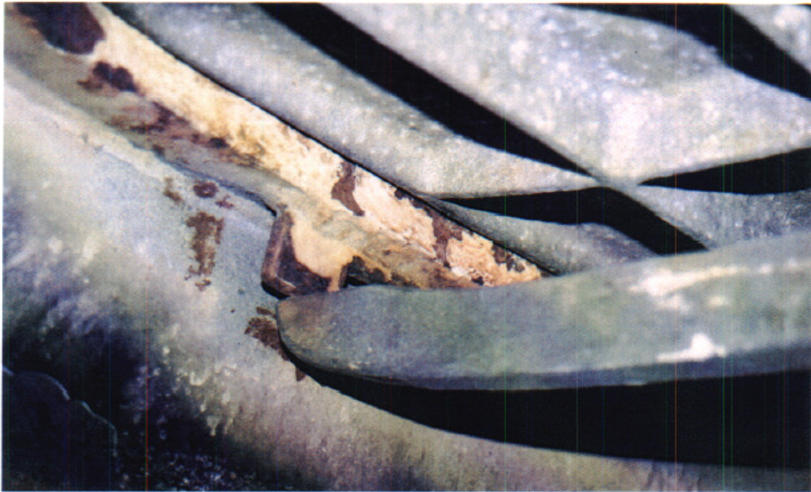
Photographie 3 – L'utilisateur a serré la barre transversale depuis le pont, à l'extérieur du compartiment. Il ne s'est pas rendu compte que la barre était appuyée sur l'extrémité de la pièce d'appui.
